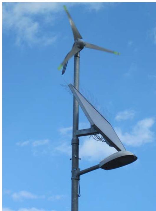
Obr. 3 Horizontální vrtulová malá větrná elektrárna (300 Wp) v kombinaci s fotovoltaickým panelem (130 Wp) a LED svítidlem o příkonu 31 W.
